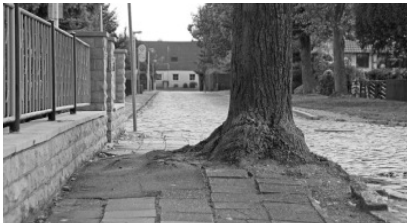
Mit Rollatoren ist dieser Fußweg in der Von-der-Heydt-Straße kaum zu befahren.
